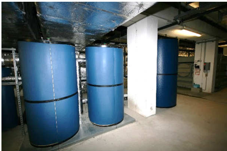
Abbildung 89: Drei wärmegeämmte Warmwasserspeicher im Technikeller des Bambados
